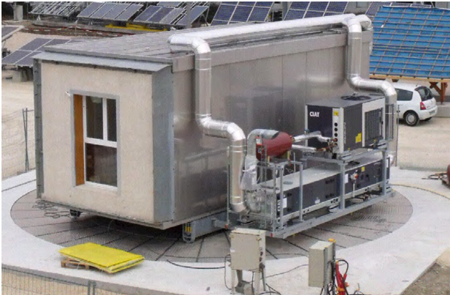
The new air handling unit.
